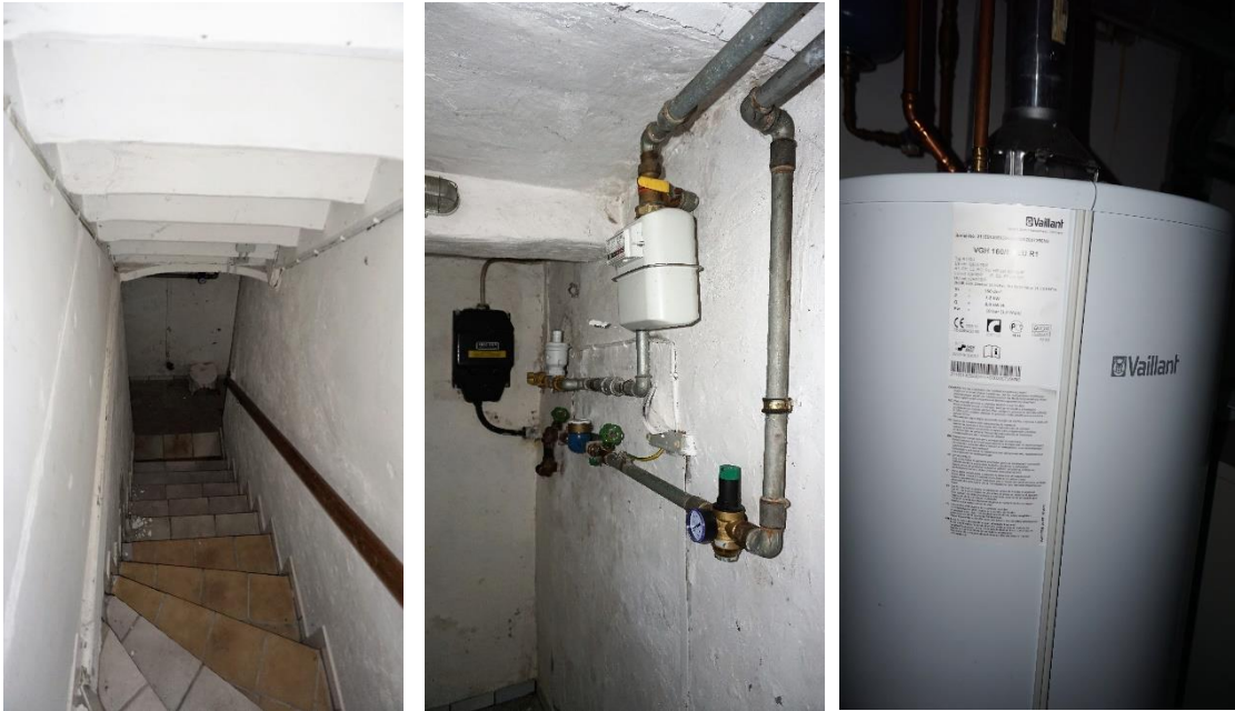
Kellereingang, Gas & Stromanschluß, Warmwasserbehälter
